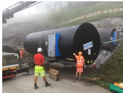
Das Reservoir wiegt rund neun Tonnen und fasst 35 m 3 Wasser. Die Brunnenstube im Hintergrund bringt rund 5 Tonnen auf die Waage.
